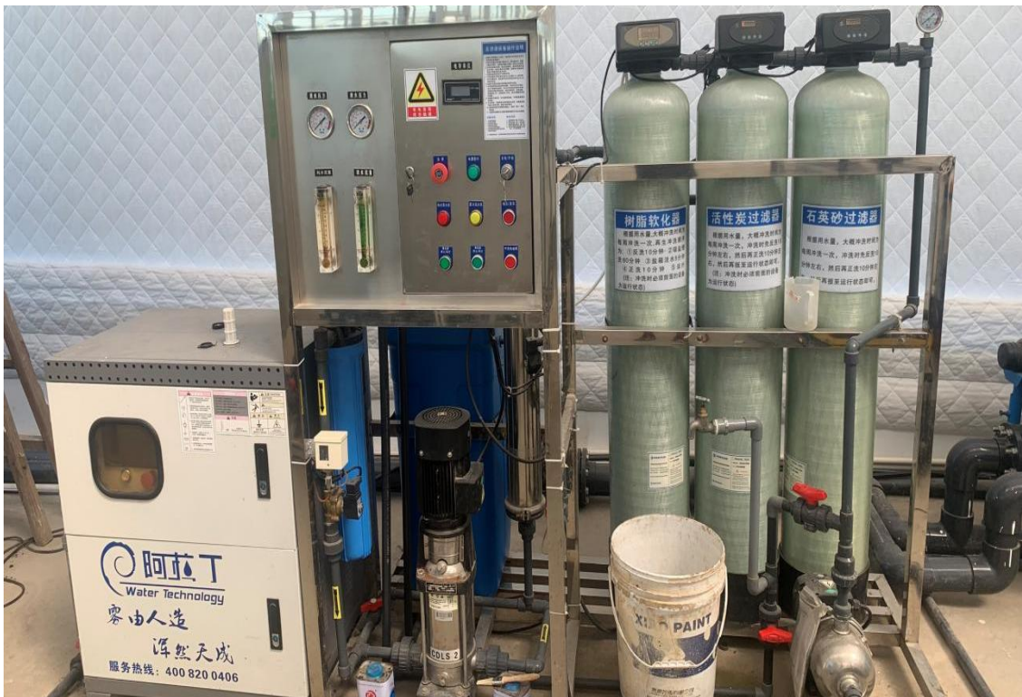
图 5 华维永州基地——活性炭过滤器
