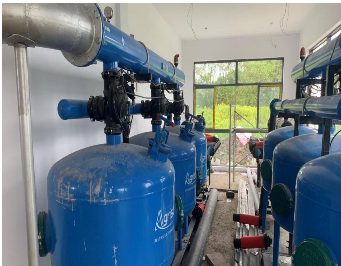
图 1 华维永州基地水肥一体化设备
